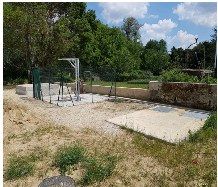
Le poste de relevage déporté avec ses 2 chambres enterrées étanches (1 chambre à vannes + 1 chambre pour la cuve NUTRIOX)
